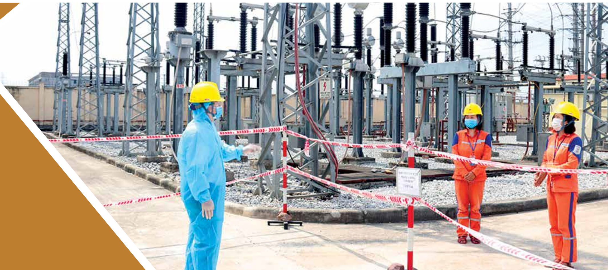
Ông Vũ Anh Phương - Phó Tổng giám đốc Tổng công ty Điện lực miền Bắc (áo bảo hộ xanh) kiểm tra công tác đảm bảo điện và động viên kíp trực tại Trạm biến áp 110kV Văn Trung (huyện Việt Yên, tỉnh Bắc Giang).
