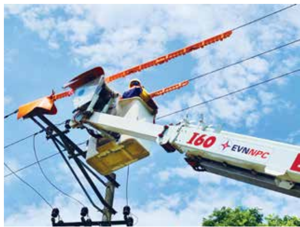
Năm 2021, EVNNPC đã xây dựng phần mềm số hóa trong lĩnh vực kỹ thuật an toàn, quản lý máy biến áp ...
