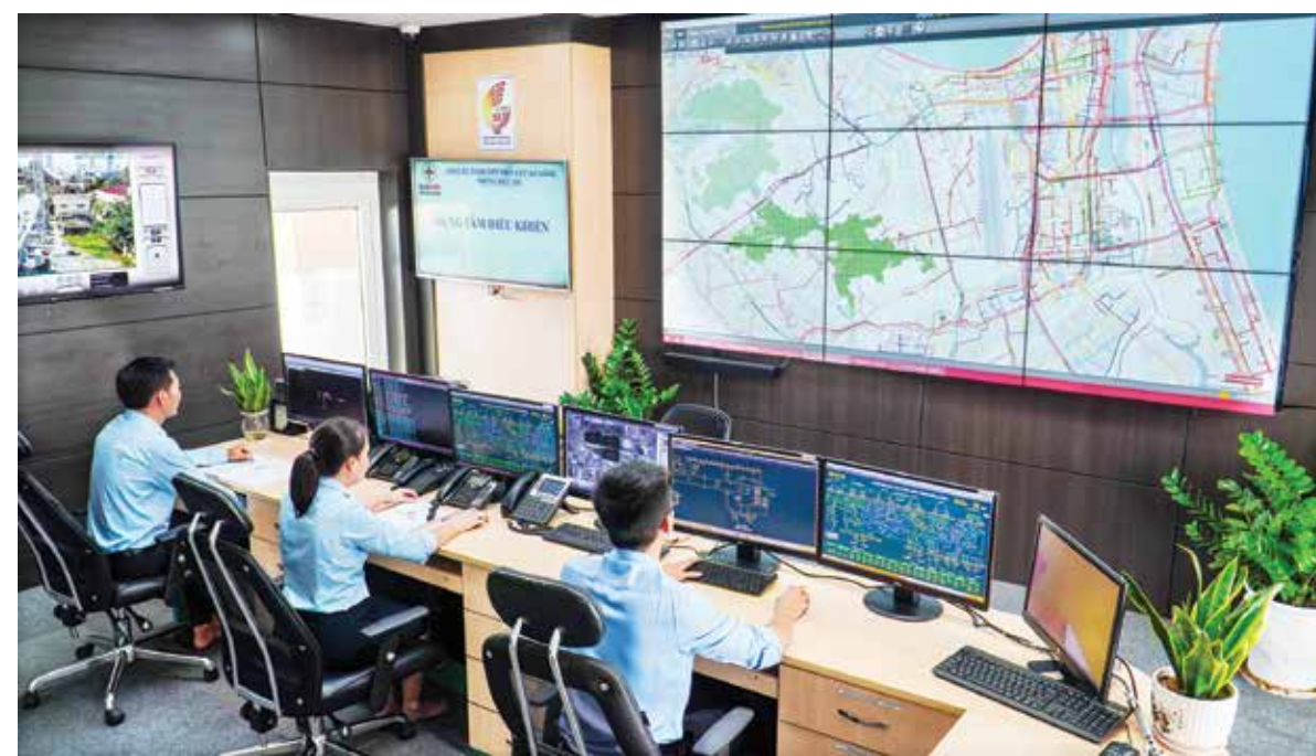
Trung tâm điều khiển lưới điện Đà Nẵng
