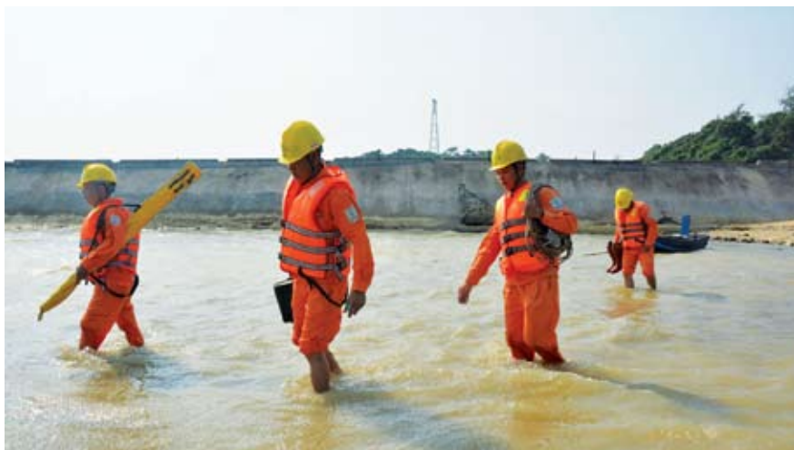
Thợ điện Cô Tô vượt sóng sang đảo Thanh Lân xử lý sự cố
