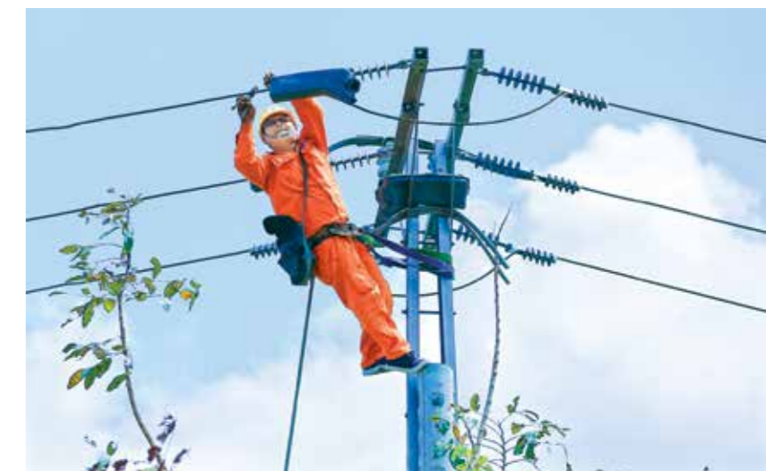
Thay trực điện, dây dẫn để đảm bảo an toàn.
