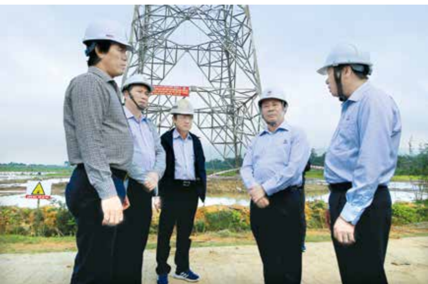
Ông Đặng Phan Tường - Bí thư Đảng ủy, Chủ tịch HĐQT EVNNPT kiểm tra thi công dựng cột tại VT 59 500 kV mạch 3 Quảng Trạch - Đốc Sỏi.
