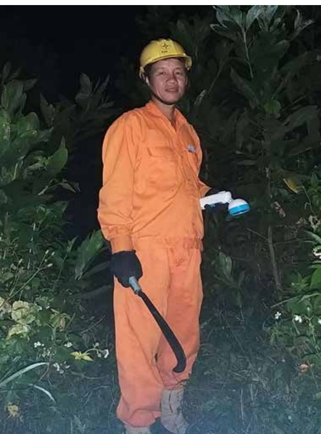
Tổ trưởng Trần Văn Hoa đang thực hiện nhiệm vụ kiểm tra đêm đường dây trung thế.
